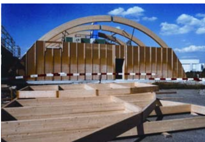
Das BSH-Bogentragwerk und ein Grossteil der geschlossenen Giebelwand sind aufgerichtet. Die Ständerkonstruktion für die transparente Stirnseite (im Bildvordergrund) wartet noch auf ihre Montage.
