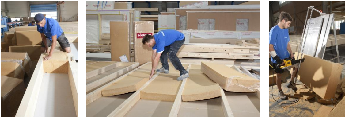
Vorfertigung der einzelnen Holzbau-Elemente inklusive Dämmung mit KRONOPLY flex (120 und 240 mm) im Werk, präziser Zuschnitt der Dämmung durch die Profi-Zuschnitt-vorrichtung mit Winkeleinstellung und Universalsäge
