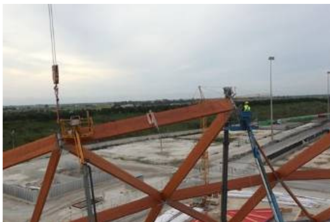
Abbildung 10: Nachdem das Brettschichtholzelement zwischen den Metallverbindungen eingefügt wurde, nimmt das Montageteam die Befestigung mittels Vollgewindeschrauben an den Metallsternen vor.
