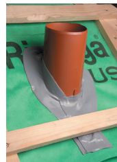
Lüftungsrohr abgedichtet mit Klebeband USB Coll 80
