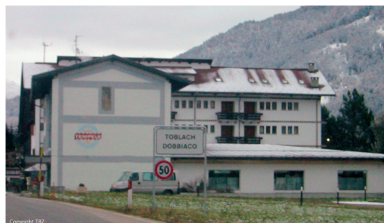
„Natürliche“ Thermografie: die ausströmende warme Luft oberhalb der Dachfenster (=ungenügende Luftdichtheit) hat ihr thermografisches Abbild hinterlassen
