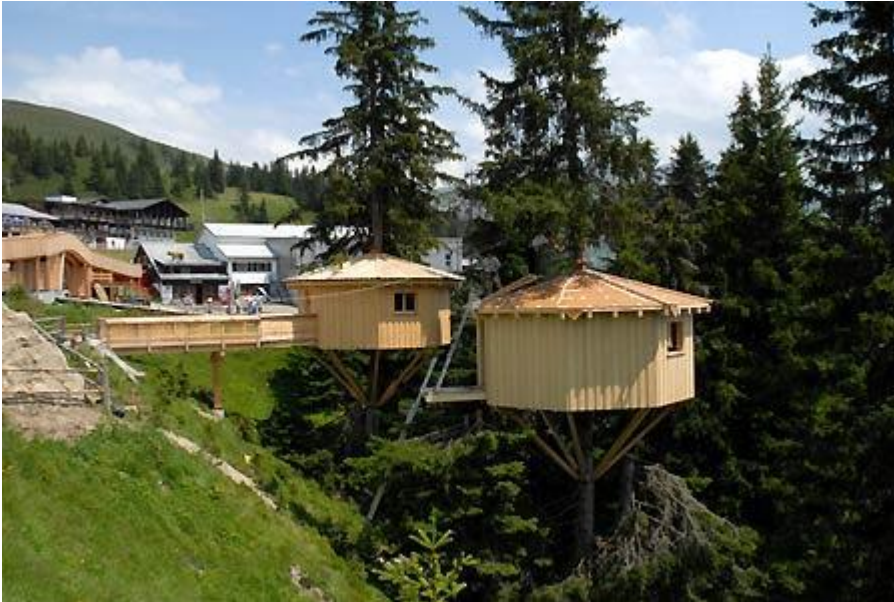
Pünktlich zur Eröffnung der ersten Etappe von Madrisa-Land waren die Konstruktionen für die beiden ersten Baumhäuser fertig gestellt worden. (Fotos / Planvorlagen: H. Bernet; Boner Holzbau AG; Ingenieurbüro FHP/ Ch. Schoop)
